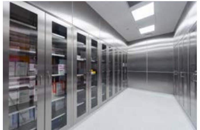
Zastosowane oprawy: Agat LED
