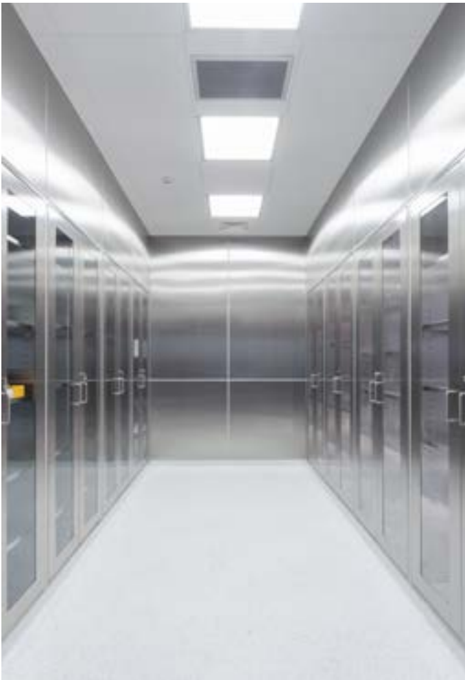
Zastosowane oprawy: Agat LED
