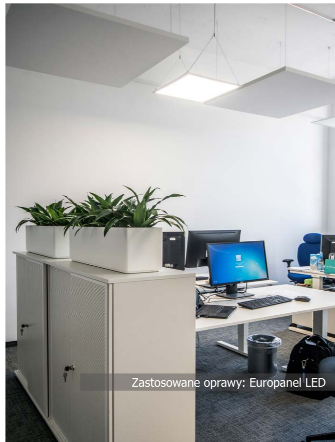
Zastosowane oprawy: Europanel LED
